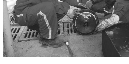
中国石化兰州石化维保公司维修二分公司不断拓宽党建工作思路,通过完善形式多样的党建活动,增强党员的凝聚力、战斗力,促进企业发展。2019年12月20日,由党员组成的技术小组正在奋力检修石油化工厂石油树脂生产装置的风机。
