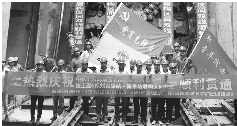
● 中铁十八局集团市政公司负责施工的成都地铁10号线二期5标刘家碾站-新平站区间双线贯通 孙可宁 伍振摄
