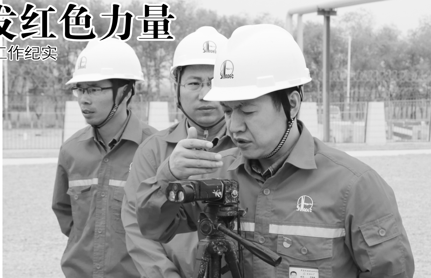
●厂党委书记顾维毅(右一)到2号联轻站改造施工现场,检查指导安全生产。
