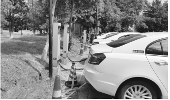
● 成都智邦科技公司研发生产、成都智充新能源公司运营的成都锦城公园充电站
